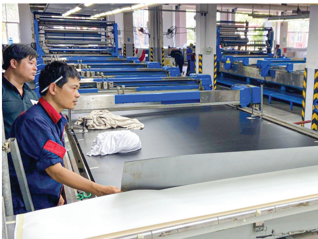
Lắp đặt dây đai, băng tải tại nhà máy dệt sợi, vải không dệt Belt installation at textile factory, non-woven fabric factory
