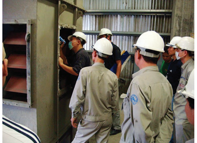
Kiểm tra thiết bị vận chuyển của Aumund Aumund conveying system inspection
